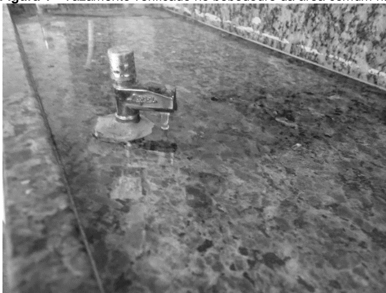
Figura 1 - Vazamento verificado no bebedouro da área comum na Escola 42
