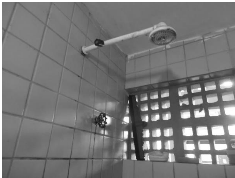
Figura 2 - Vazamento verificado no registro do chuveiro do banheiro masculino dos funcionários na Escola 42
