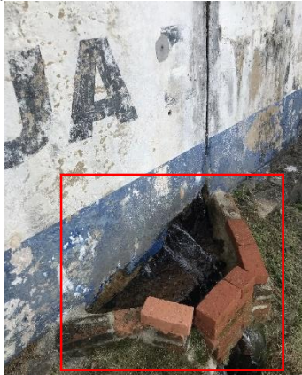
a) Ponto de vazamento
