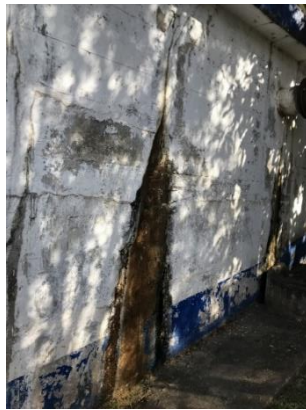
b) Patologias na parede lateral esquerda
