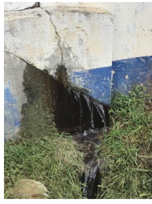
c) Rachadura na parede frontal
