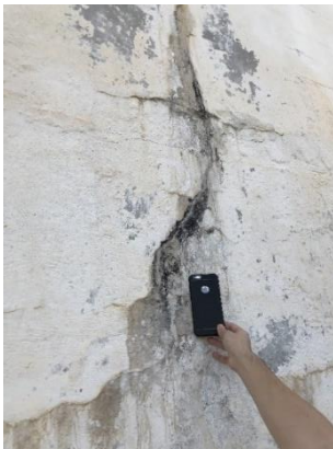
a) Parede frontal com fissura, bolor e eflorescência
